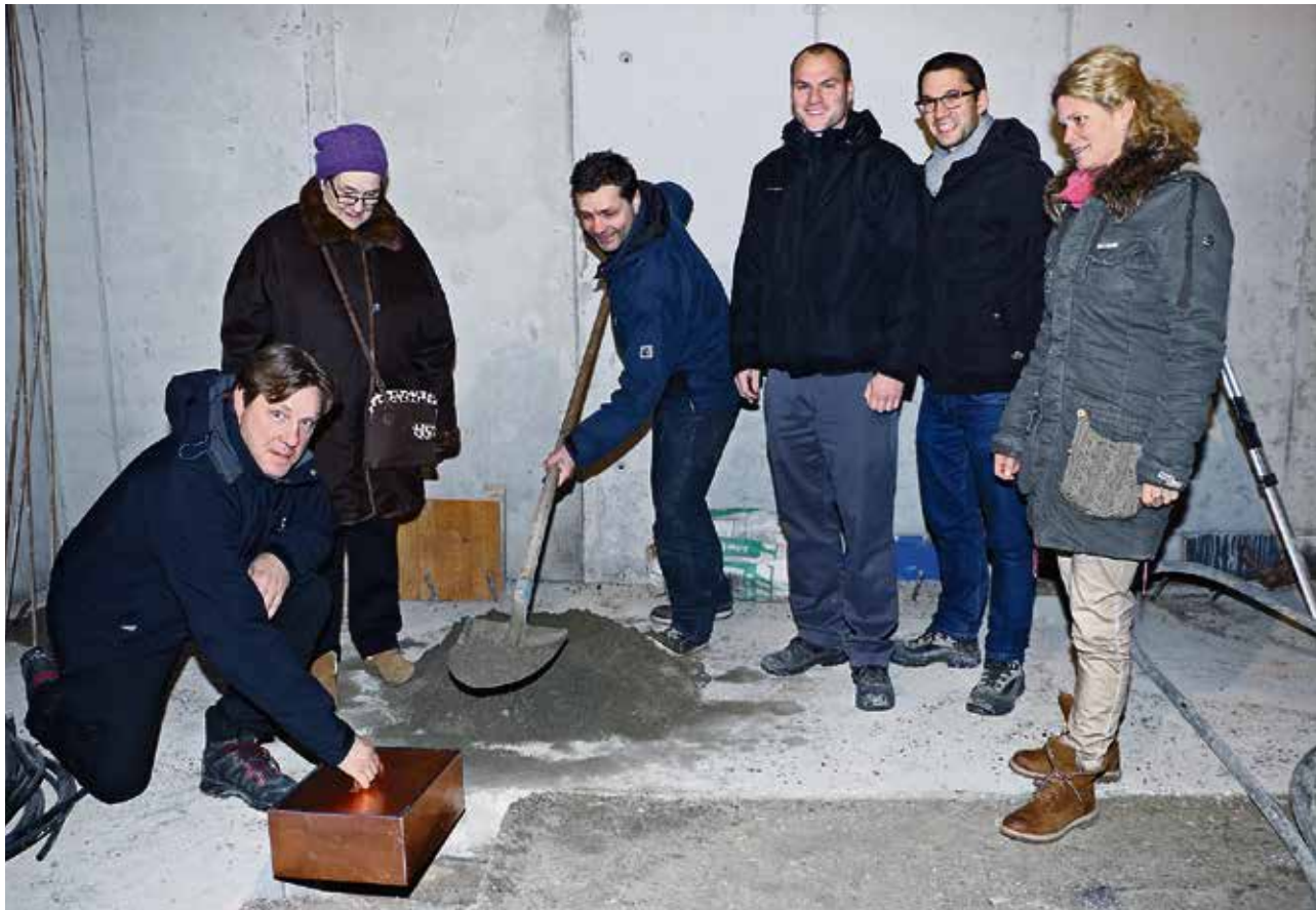
Eine Schatulle für Nachfahren eingemauert: Die Bauherrschaft Christian, Rosmarie und Daniel Herrmann, Architekt Marcel Frauenfelder, Bauleiter Pascal Peter und «Andelfinger Zeitung»-Verlegerin Julia Akeret. Bild: spa
